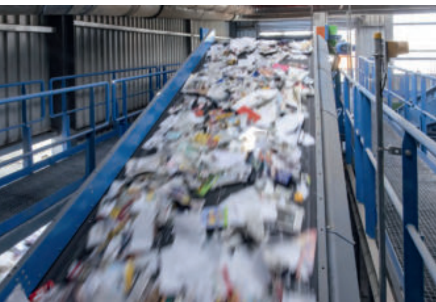
Die neue Altpapier-Sortieranlage im Einsatz
